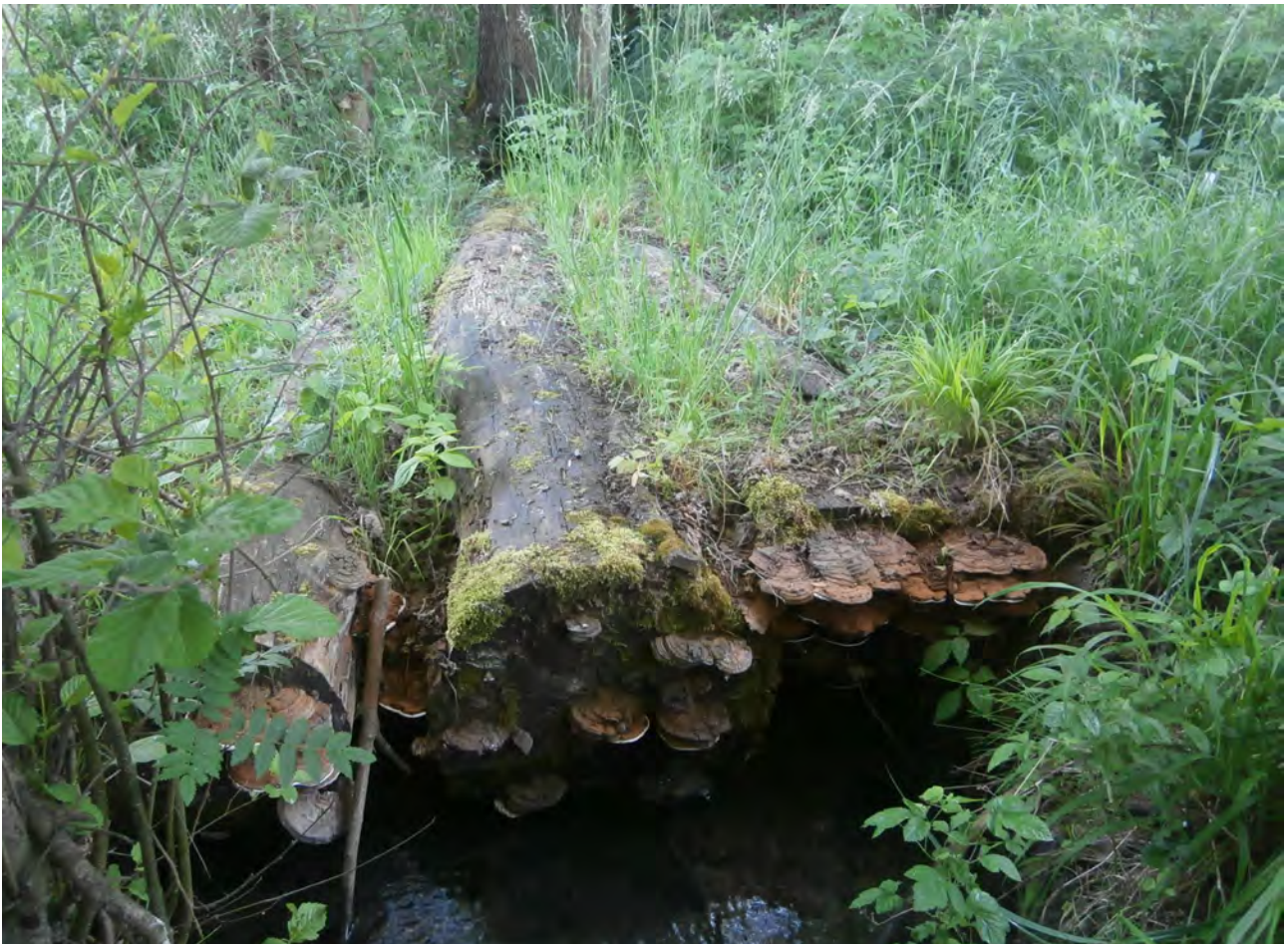
Foto 11 a 12: Chatrné dožívající mostky přes příkopy mezi loukami v JZ části PP. Pro přístup na kosené plochy bude nutné mostky dříve či později rekonstruovat.
